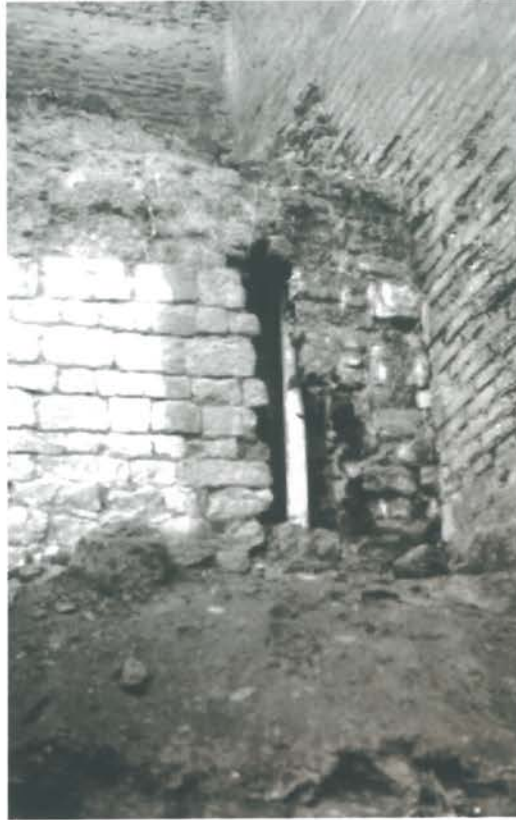
Foto 8 -Detalle de uno de los desagües situados en el Lienzo I antes de la restauración.
